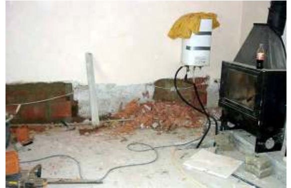
Ölschaden nach Hochwasser
